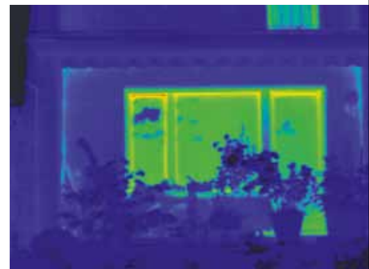
Na de zorgvuldige inbouw van nieuwe Corona CT 70-ramen bewijst de thermografie het hoge energiegerelateerde nut van de investering. Het oorspronkelijke energieverlies wordt praktisch volledig vermeden.
